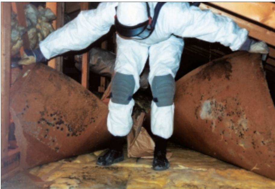
Homevaurioita lämpöeristeissä ja kuitulevyissä.
